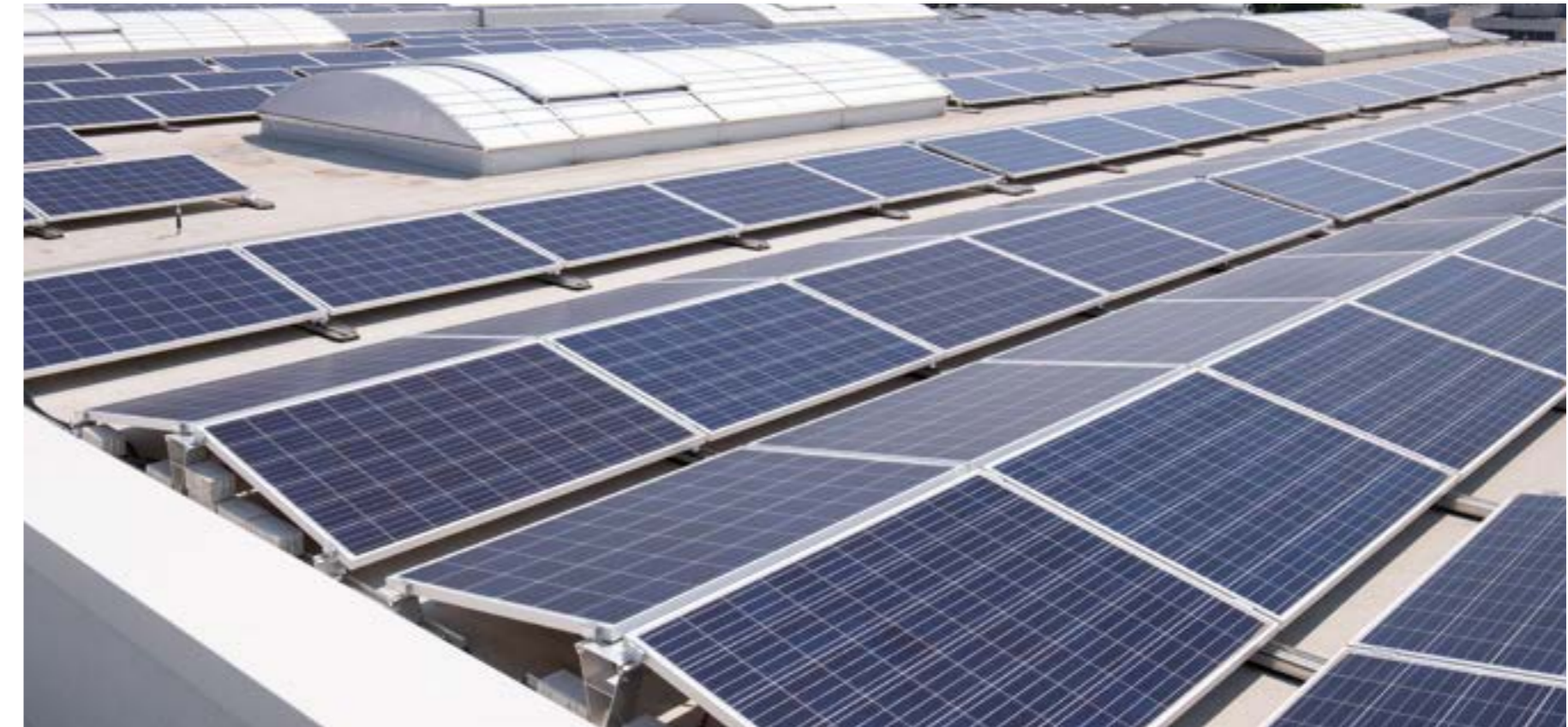
Abb. 30 Fotovoltaik auf dem Flachdach © geoki / stock.adobe.com
