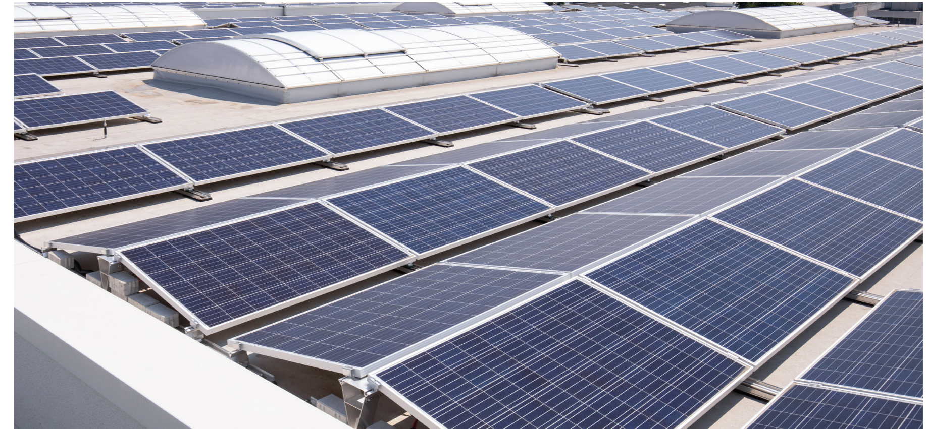
Abb. 30 Photovoltaik auf dem Flachdach © geoki/stock.adobe.com
