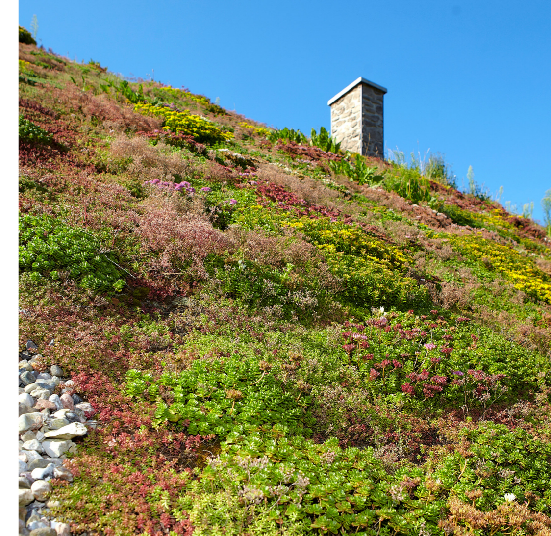
Abb. 51 Dachbegrünung auf dem Schrägdach © Achim Banck/stock.adobe.
